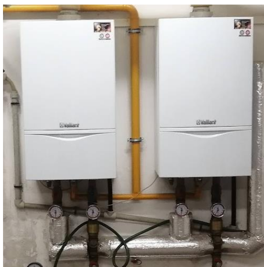
Obrázek 6 – Instalované plynové kotle
