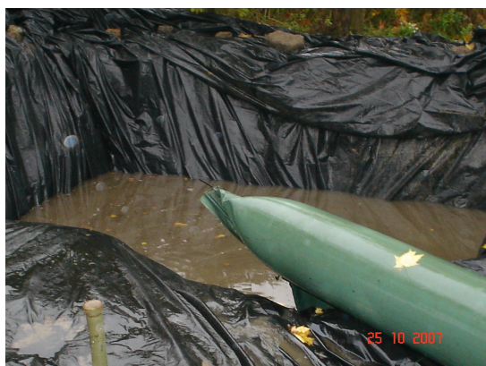
Obrázek č.15a – Norná stěna svádějící vodu do jímky.
