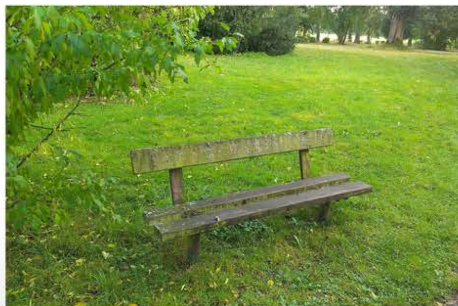
Obr. č. 78: Lavičky jsou v parku neudržované. Částečně již porostlé mechy a lišejníky. (foto: autor)
