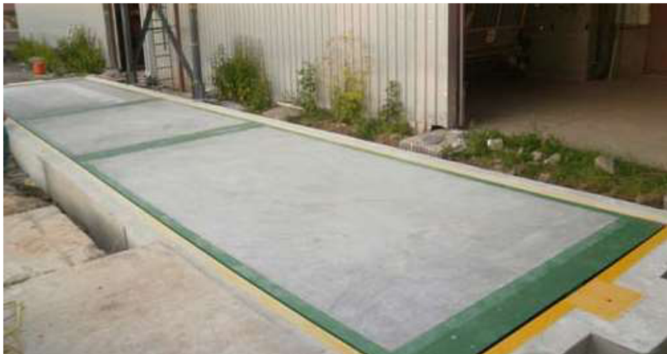
Obr. 8 Zabudovaná mostní váha v blocích (B)
