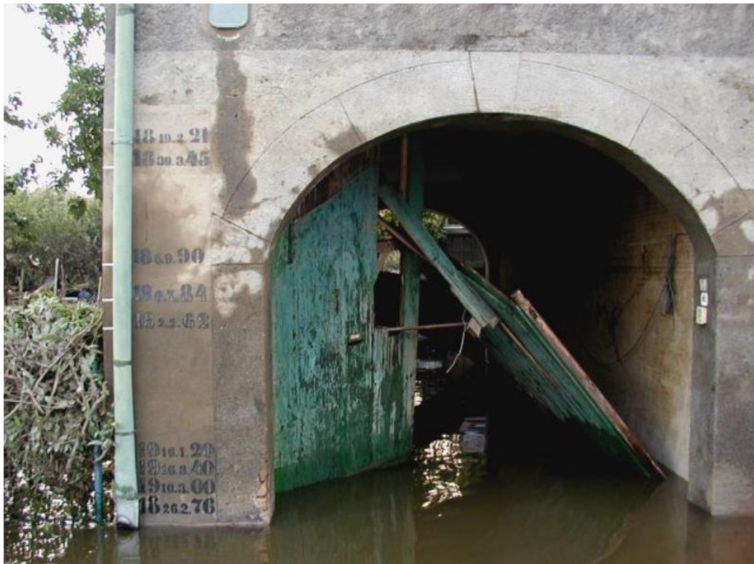
Příloha 3 - Značky historických povodní na dolním toku Labe v Křešicích po povodni v roce 2002 (zdroj: SDH Křešice ©2021).
