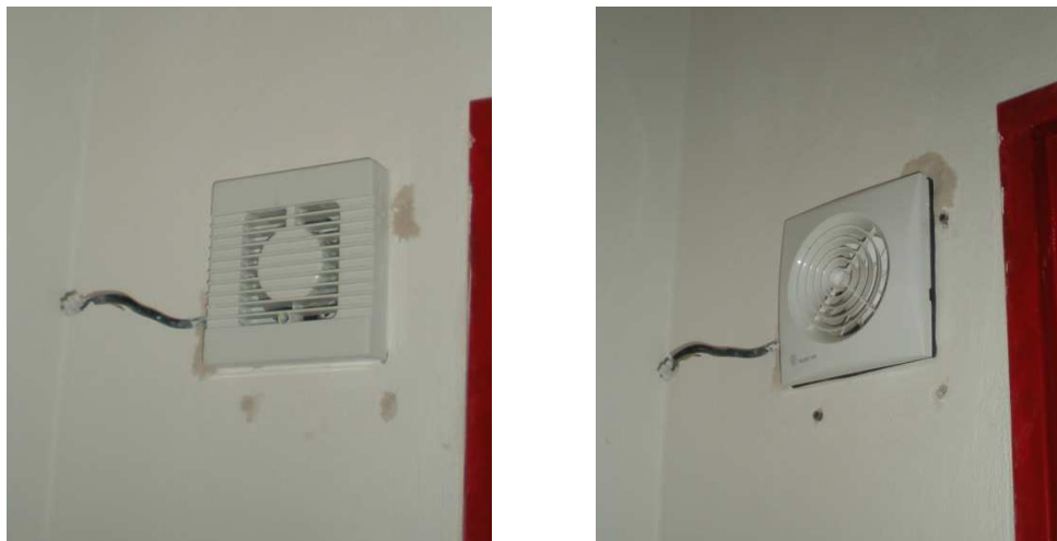
Obr. 15 Příklad osazení ventilátorů - vlevo var.1 bez pryže, vpravo var.3 s pryží
