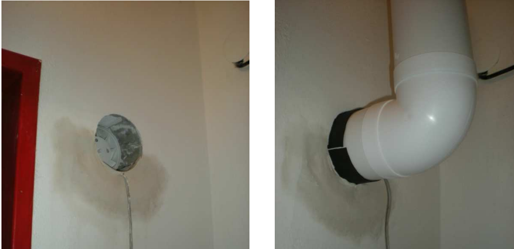
Obr. 17 Ukázky z realizace měření - vlevo výfuk do volného prostoru, vpravo navazující výfukové potrubí s pryžovou izolací
