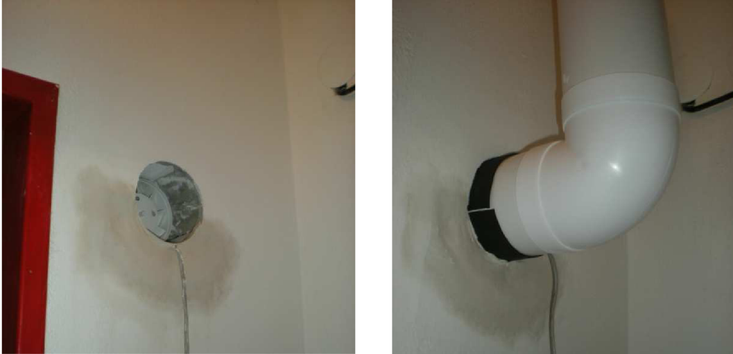
Obr. 17 Ukázky z realizace měření - vlevo výfuk do volného prostoru, vpravo navazující výfukové potrubí s pryžovou izolací
