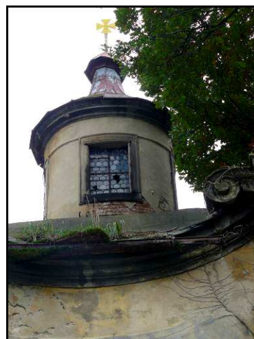
Obrázek 27 - Nefunkční svod vody, foto: Dvořák, 2014
