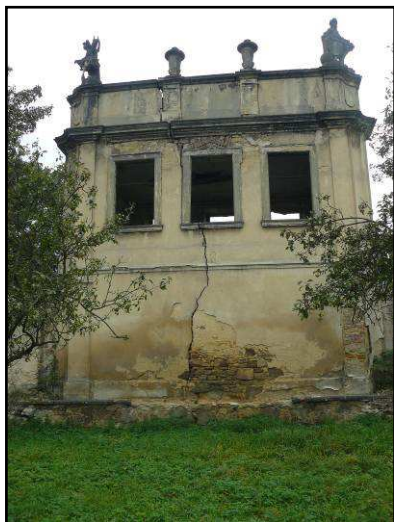
Obrázek 34 - Trhlina napříč východním gloriem, foto: Dvořák, 2014
