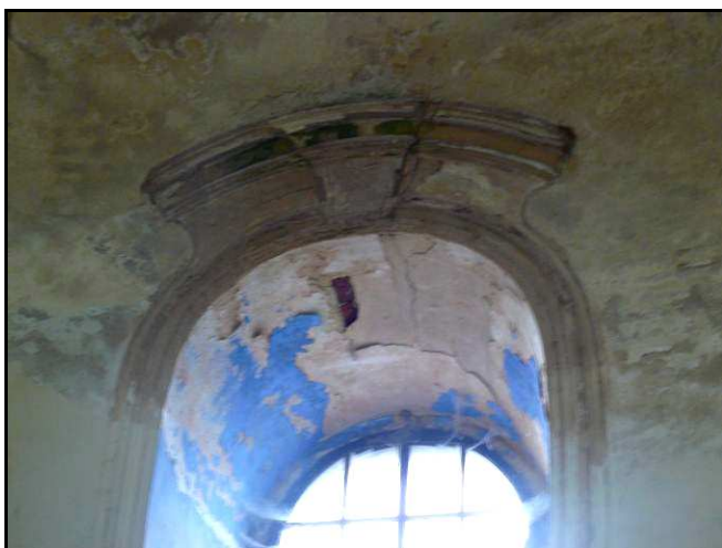
Obrázek 26 - Znamky zatékání vodou, foto: Dvořák, 2014
