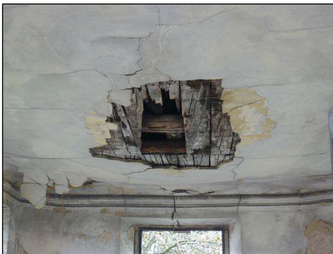
Obrázek 35 - Poškození stropu gloriety, foto: Dvořák, 2014
