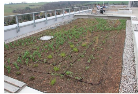
Obr. 116 – Kapková závlaha se střeše budovy FAPPZ ČZU; Zdroj: autor práce
