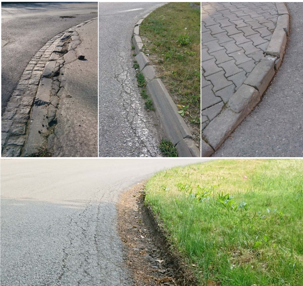
Obrázek 1 - Poškození okrajových částí vozovky pojezdem vozidla
