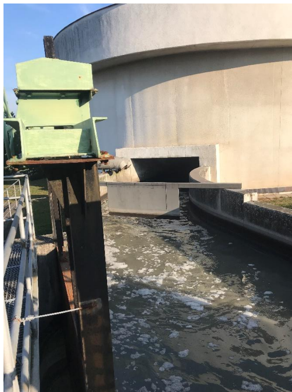
Příloha 4 Odtok vody z čerpací stanice
