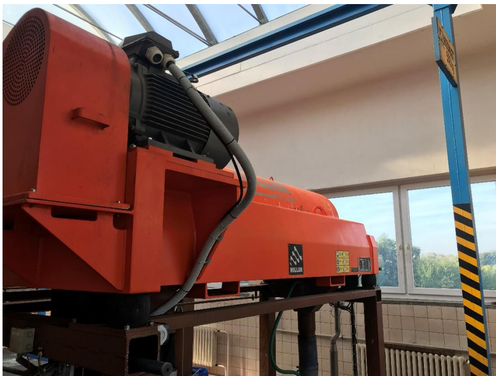
Příloha 12 Odstředivka pro odvodňování kalu
