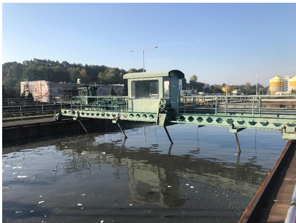
Příloha 6 Usazovací nádrž
