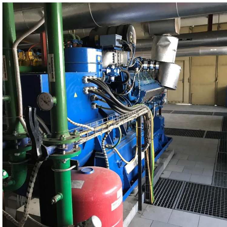
Příloha 14 Kogenerační jednotka
