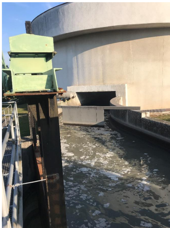
Příloha 4 Odtok vody z čerpací stanice
