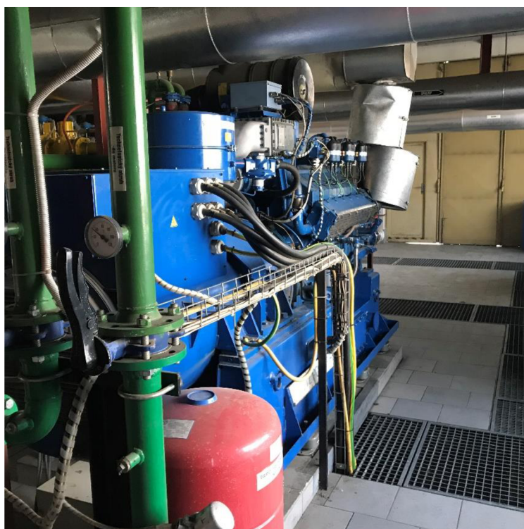
Příloha 14 Kogenerační jednotka
