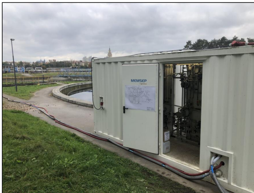
Obrázek 8 Kontejnerová poloprovozní jednotka na ÚČOV [28]
