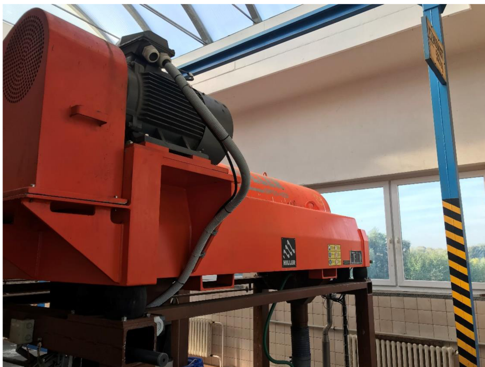
Příloha 12 Odstředivka pro odvodňování kalu
