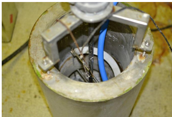
Obr. 50: Detail horního otvoru dehydrátoru
