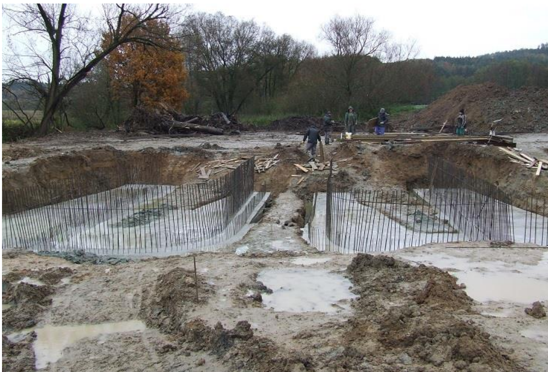
Příloha č. 5: Výstavba základů funkčního objektu suchého poldru (zdroj: archiv obce Cehnice)
