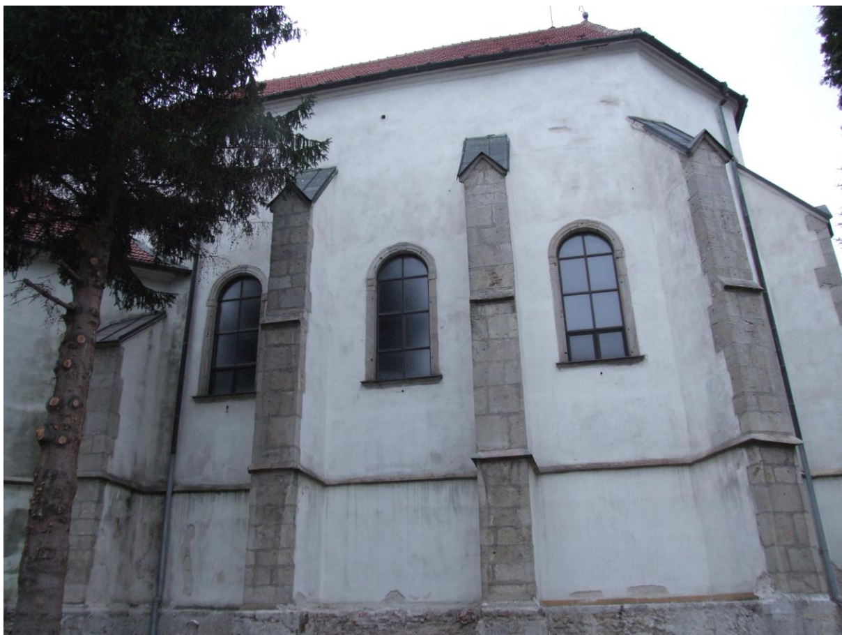
Obr. 130 Kostel Panny Marie v Novém Městě nad Váhem, pohled na presbytář od jihu.
