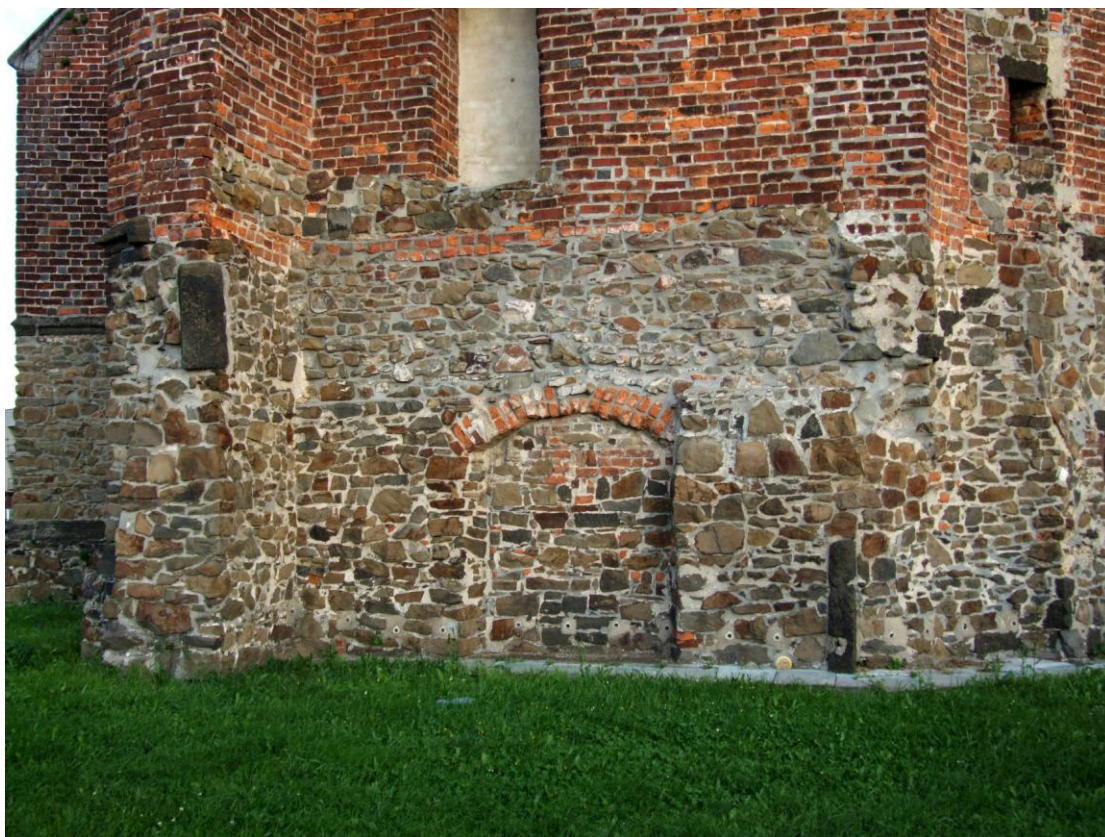
Obr. 191 Opava – Kateřinky, kaple sv. Kříže, pohled na severní průčelí v detailu úrovně přízemí.
