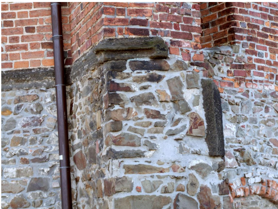
Obr. 193 Opava – Kateřinky, kaple sv. Kříže, detail ostění okna sakristie a úseku kordon. římsy pilíře.
