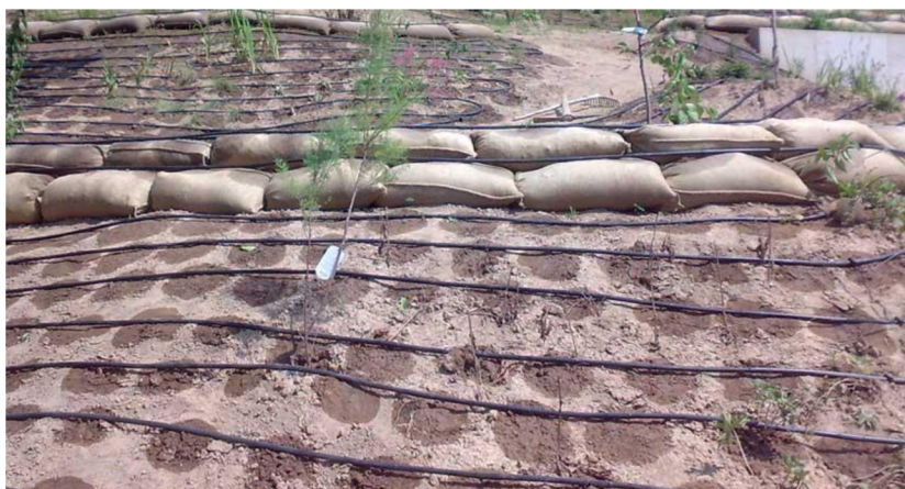
Obr. 13 Zavlažování kapkovacím potrubím [11]
