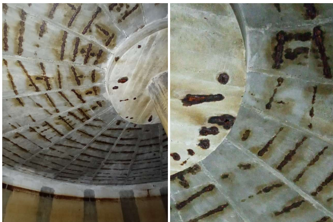
Obr. 6.13 Odkrytá výztuž betonového stropu akumulční nádrže
