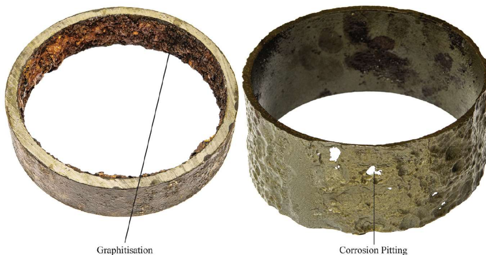
Obr. 3.5 Grafítizace a bodová koroze potrubí
