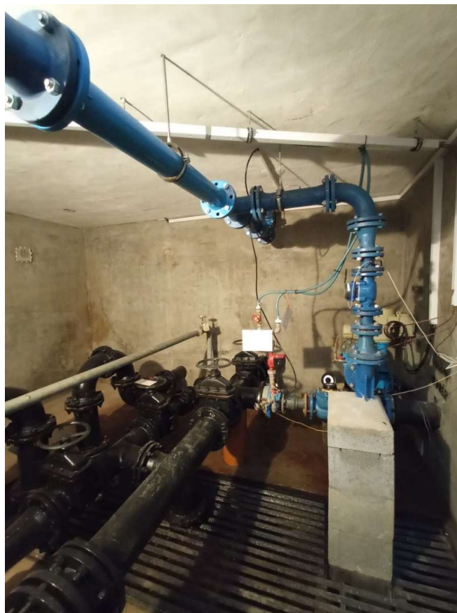
Obr. 6.17 Armaturní komora vodojemu
