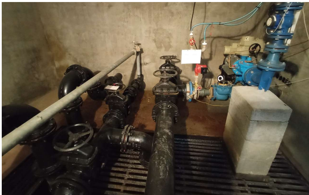
Obr. 6.16 Armaturní komora vodojemu
