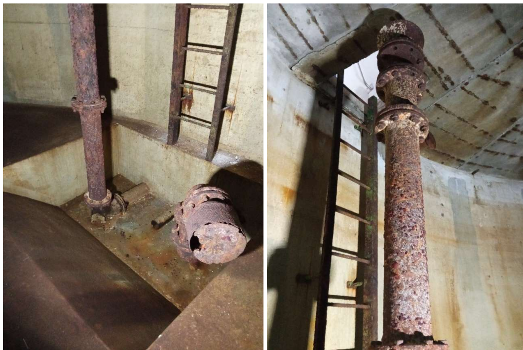
Obr. 6.14 Degradace materiálu objektů akumulční nádrže vlivem stáří a koroze
