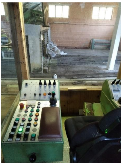
Obrázek č. 32 - Kabina obsluhy pily
