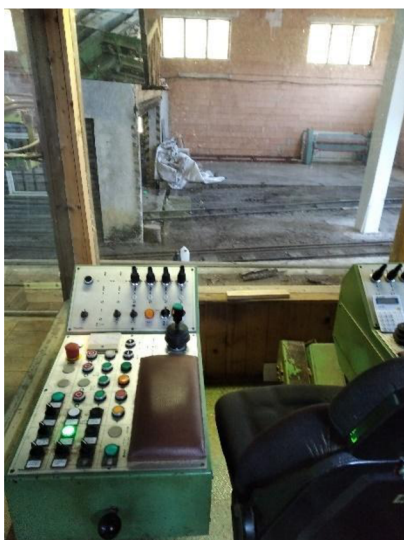
Obrázek č. 32 - Kabina obsluhy pily
