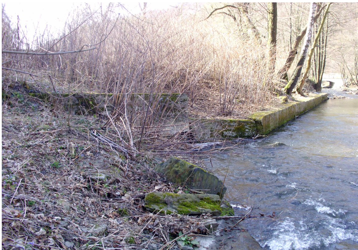
Foto 3 Zbytky původního levobřežního pilíře [7]
