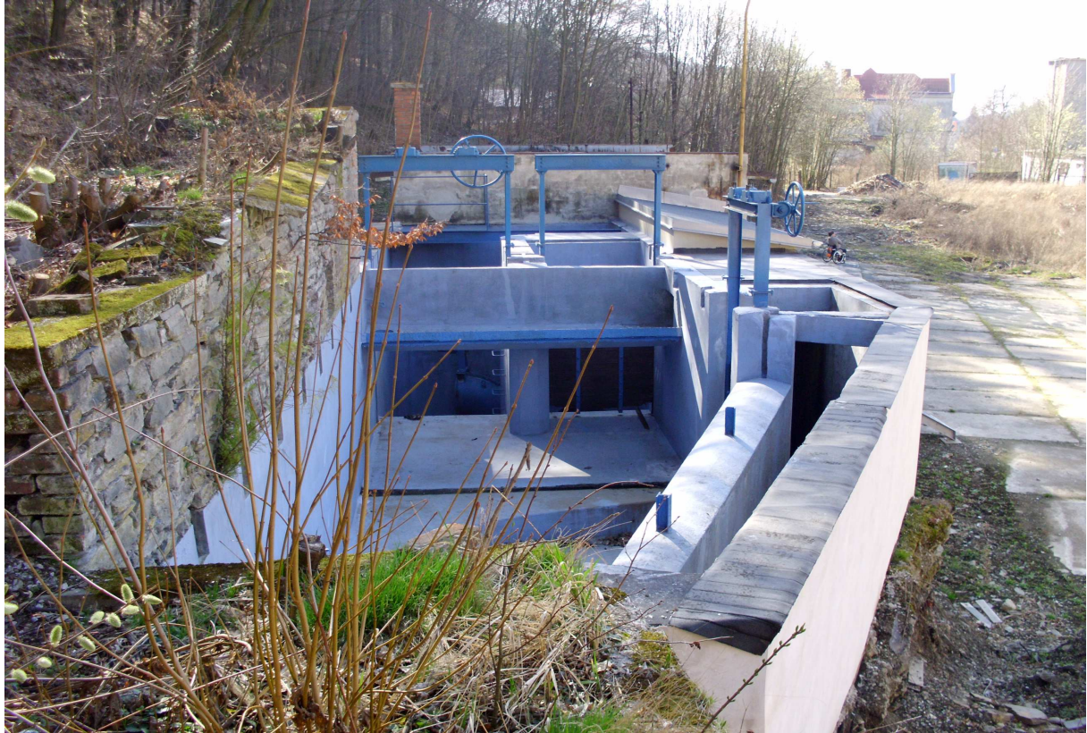
Obr. 4 Stejný pohled od betonového přivaděče po odstranění nánosů a vegetace. Zcela vlevo nátok na větší z turbín, uprostřed nátok na menší turbínu a vpravo jalový přeliv [7]
