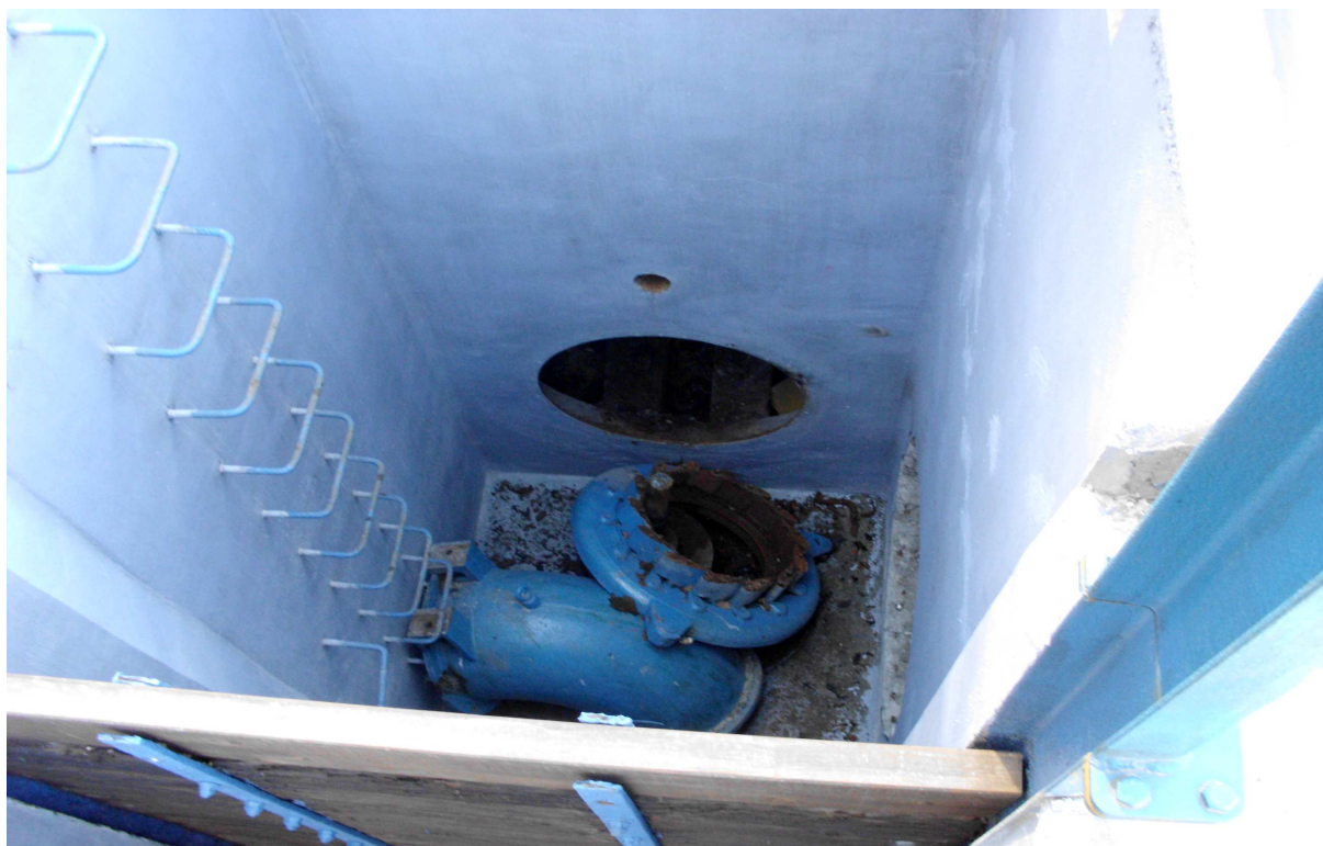
Foto 8 Pohled na demontovanou malou Francisovu turbínu stav v roce 2013 [7]
