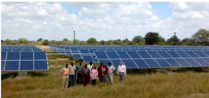
Obr. 8: Solární fotovoltaicko-diesellový hybridní systém v Tsumkwe
