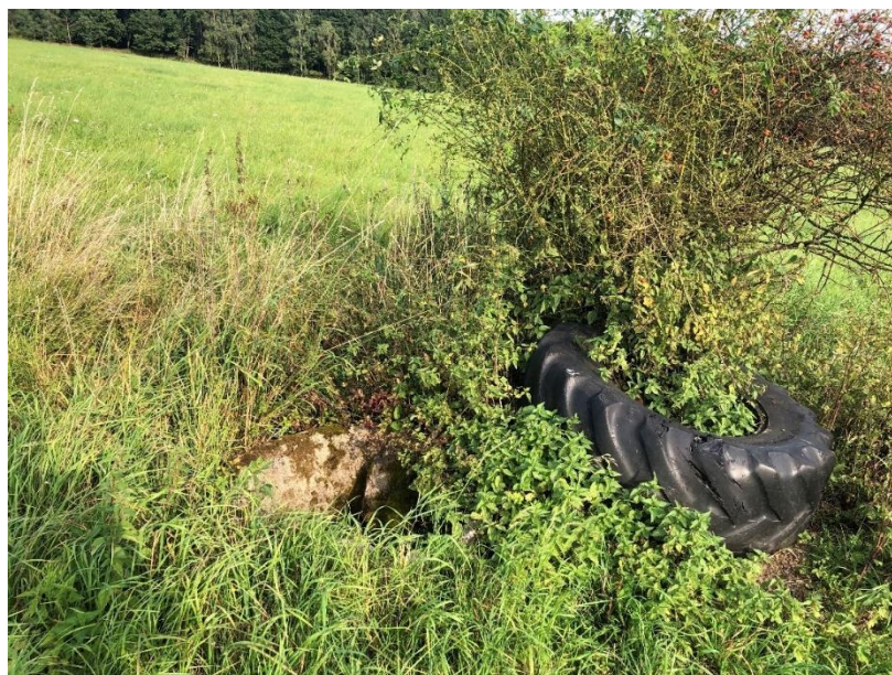
Obrázek 4: Neudržovaný drenážní systém, kontrolní šachtice, k. ú. Rýdeč, 13. 9. 2021 (vlastní foto)
