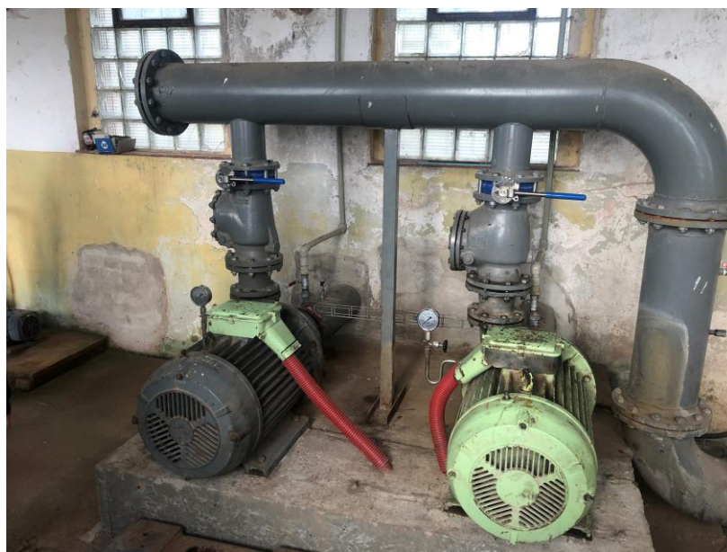
Obrázek 5: Interiér závlahové čerpací stanice Rohozec u řeky Doubravy, ZOS Kačina, a.s., 13. 10. 2021 (vlastní foto)
