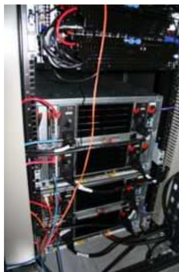
Obr. 1. 2. Stejný server rack vyfocený zezadu
