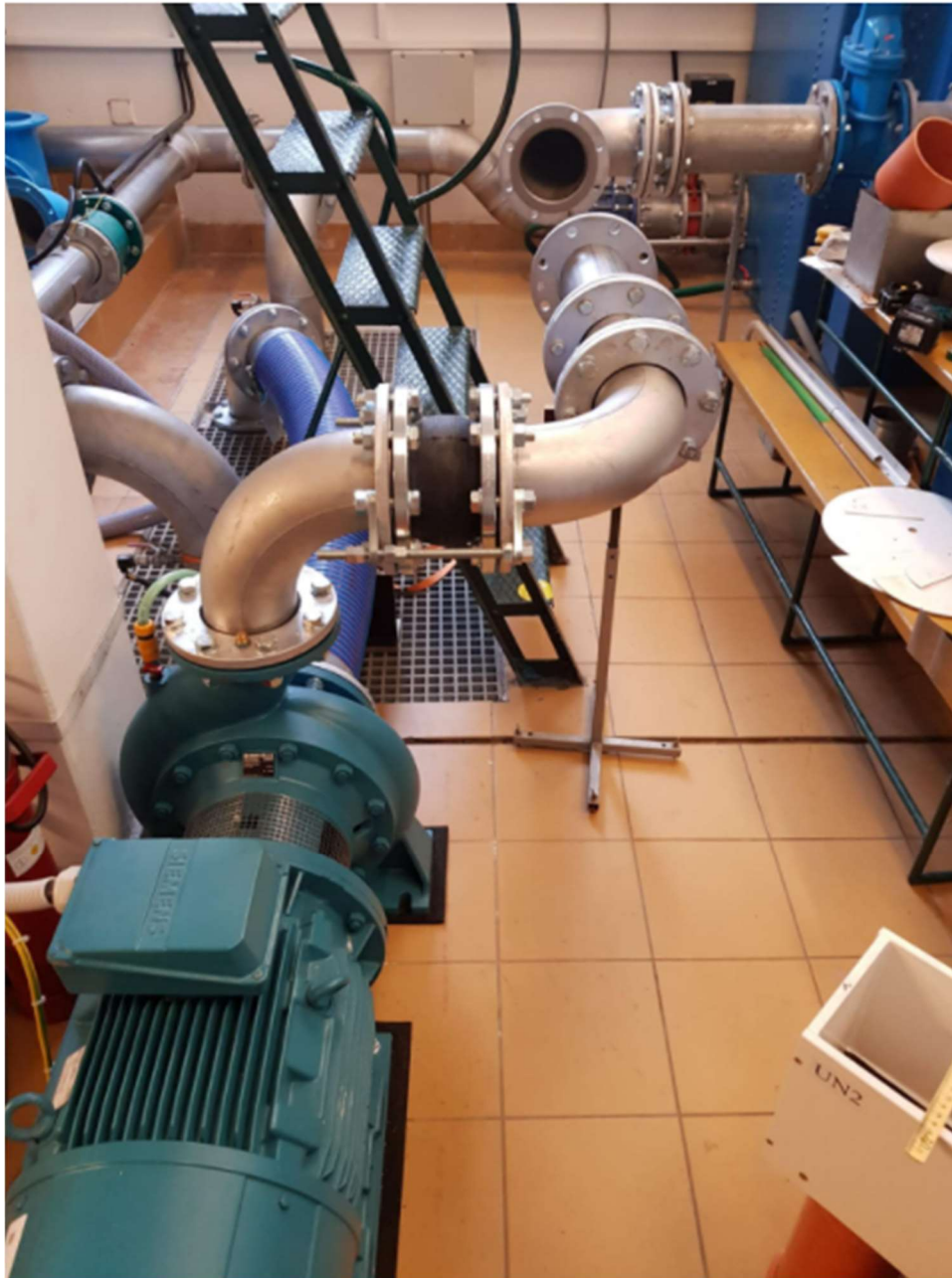
Obr. 8 Pryžový kompenzátor osazený na výtlačné větvi čerpadla
