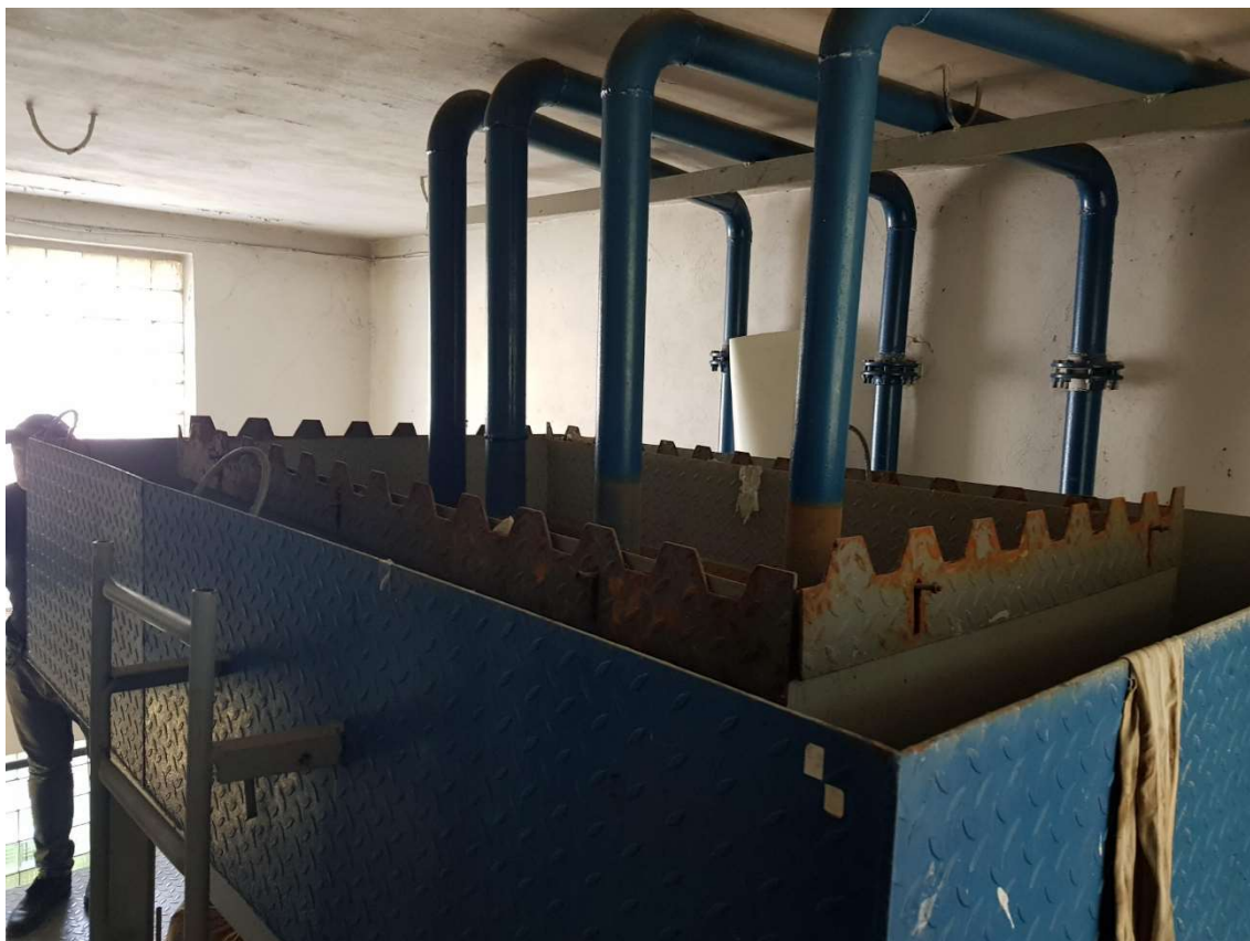
Obr. 5 Horní uklidňovací a rozdělovací nádrž, přívodní shora zaústěné potrubí od čerpadel
