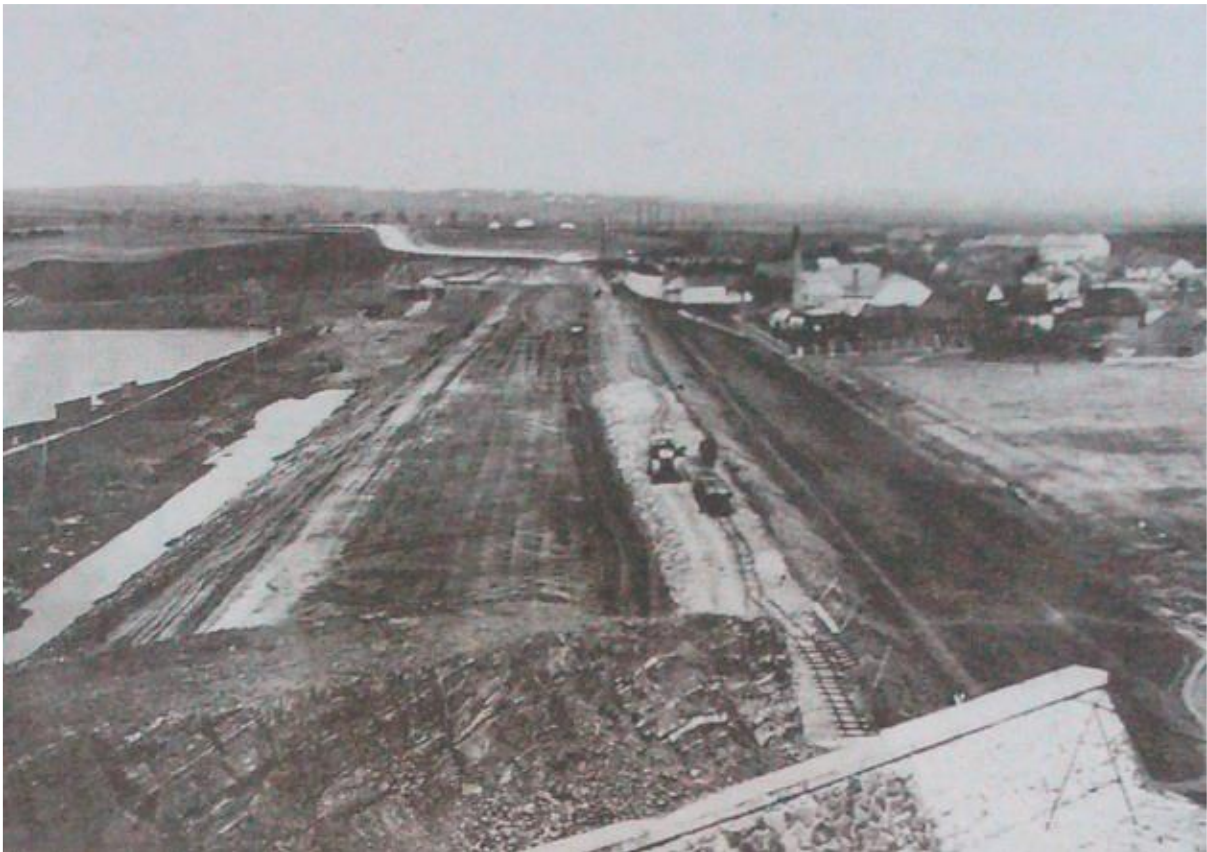
Fotodokumentace č. 1 - Budování hráze přehrady. (Zdroj: Prostějovská přehrada měla napájet průplav. Prostějovský týden 7(28), 1997).
