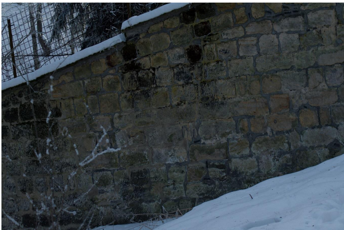
Obr. 105: Pískovcová zeď s cementovou maltou
