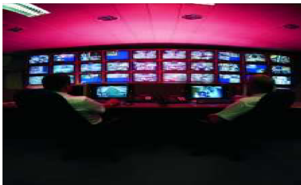
Obrázek 3.3: Pult centralizované ochrany (PCO)[8]
