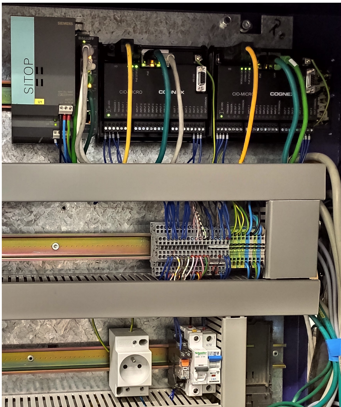
Obr. D.1: Skutečné provedení rozvaděče
