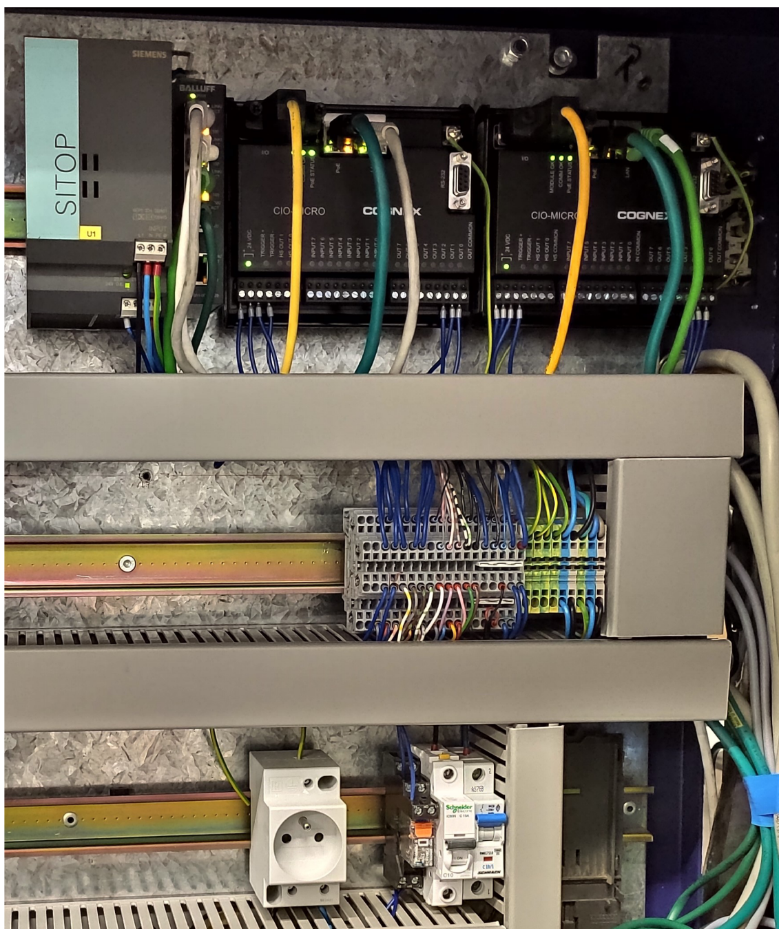
Obr. D.1: Skutečné provedení rozvaděče
