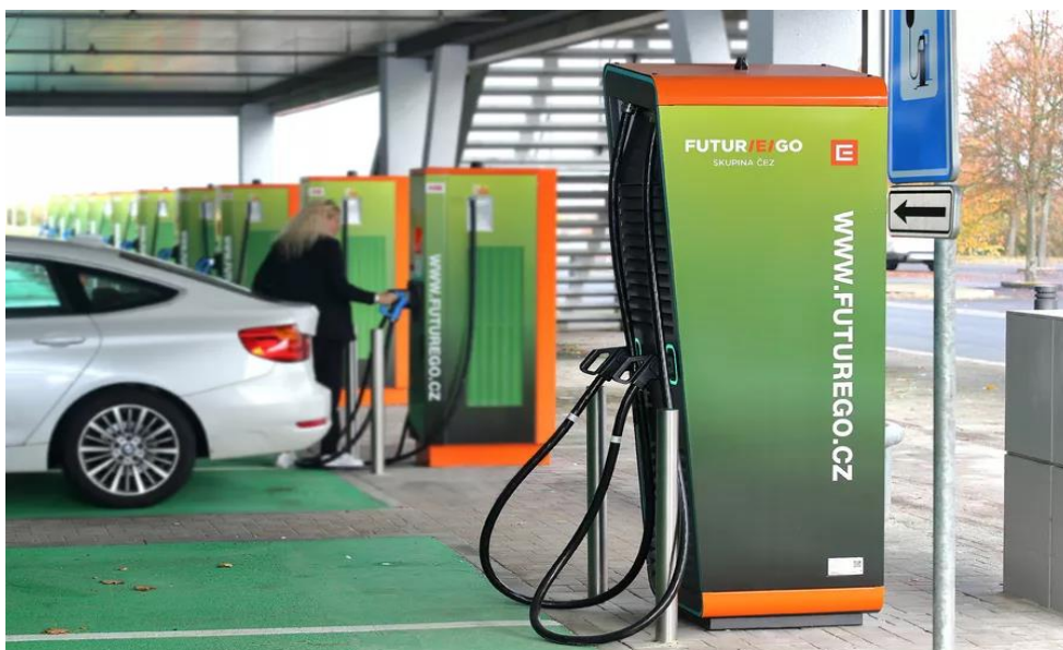
Obrázek 17 - Veřejná DC dobíjecí stanice. Zdroj ČEZ
