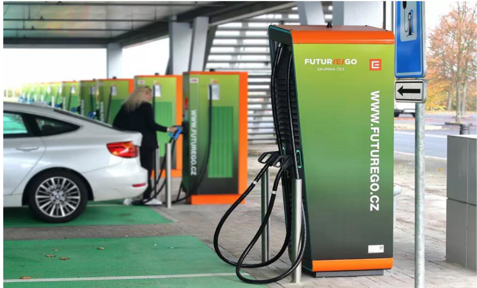
Obrázek 17 - Veřejná DC dobíjecí stanice. Zdroj ČEZ
