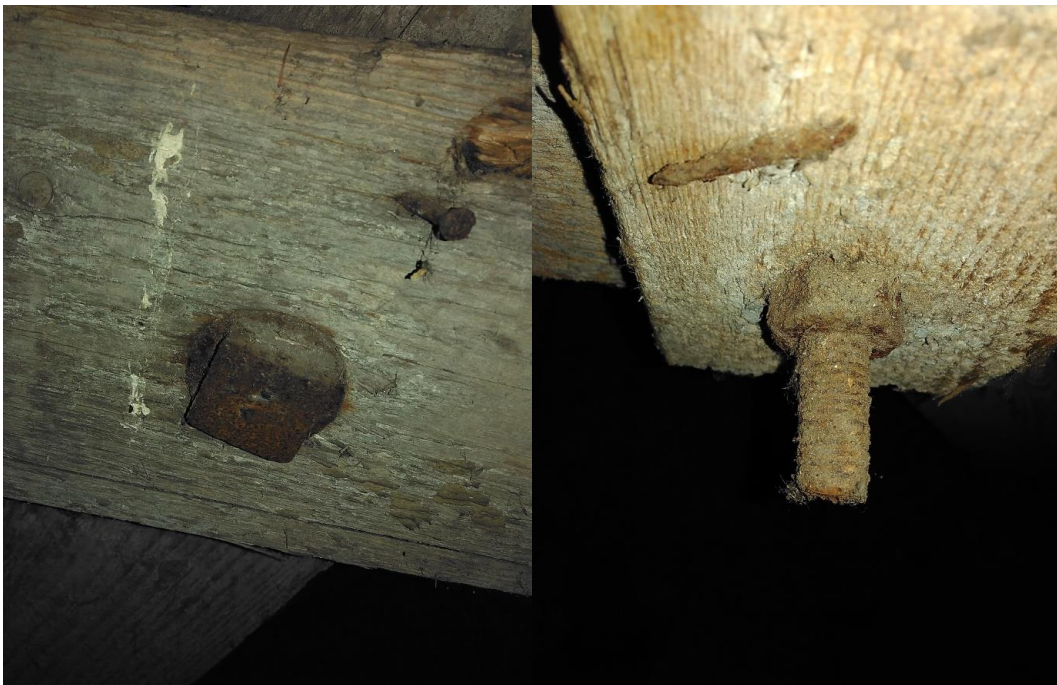
Obr. 26: Nejčastější spoj dřevěných prvků, který se vyskytoval na obou krovech – čtyřhranný šroub s podložkou a maticí
