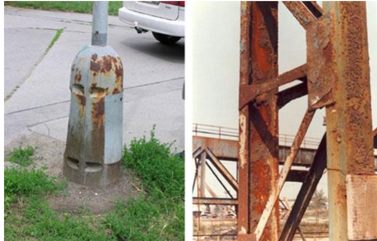
Obr. 10: Koroze v atmosféře [27]
