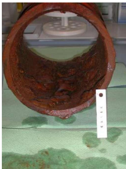
Obr. 11 Koroze ve vodách [25]
