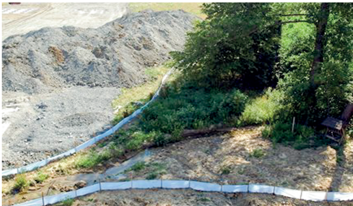
Obrázek 2: Bariéry určené pro ochranu obojživelníků v blízkosti stavby (©Natura Servis s.r.o.)
