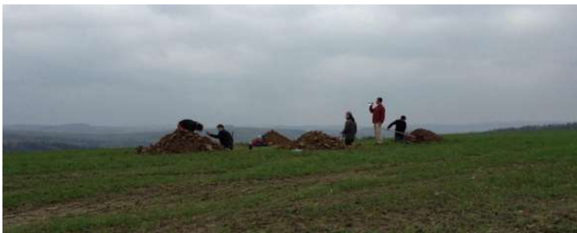
OBRÁZEK 217 KRYCÍ NÁZEV HROBY- VÝKOP ZÁKLADŮ PRO KAPLI - JAN AMBRŮZ. (FOTO JAN AMBRŮZ, LISTOPAD 2013)
