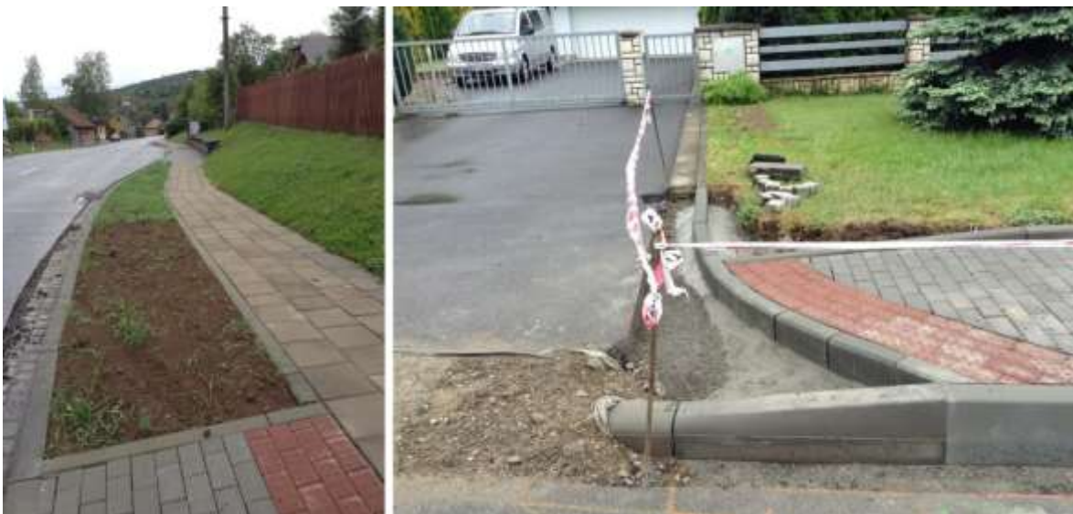
OBRAZEK 186 NEVHODNÉ ŘEŠENÍ DETAILŮ SILNICE. NEDOSTATEČNÝ PROSTOR PRO VÝSADBU STROMŮ. NECITLIVÉ DLOUHODOBÉ ŘEŠENÍ, NEVHODNÉ MATERIÁLY. (FOTO JAN AMBRŮZ, 2014)
