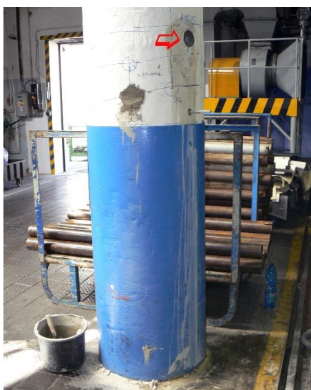
Obr. 4.18 Místo sondy M1V6 do sloupu v 1. NP
