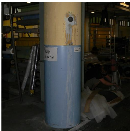
Obr. 8.22 Místo sondy M2V6 do sloupu v 2. NP
