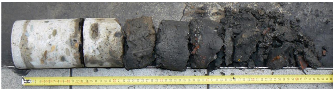
Obr. 4.10 Jádrový vývrt v místě sondy HV1 o průměru 100 mm a délce přibližně 600 mm
