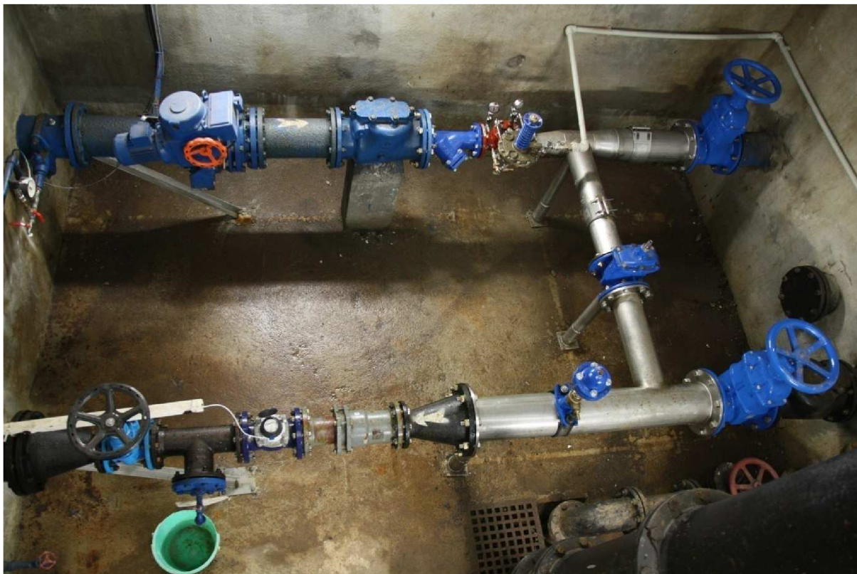
Obr. 3.5 Pohled do armaturní komory
