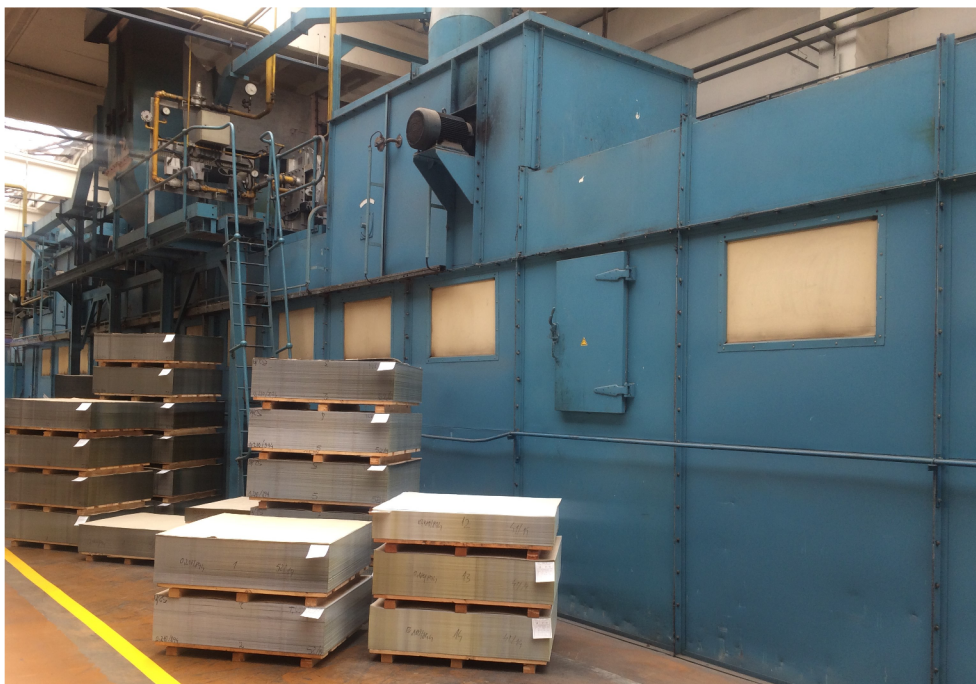
Obr. 5.5: Vypalovací pec (v popředí složené tabule plechů).
