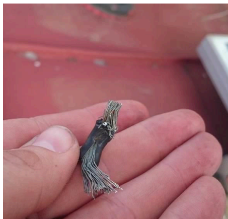
Obrázek 9 Část kabelu s poškozenou izolací kabelu o nosnou konstrukci
