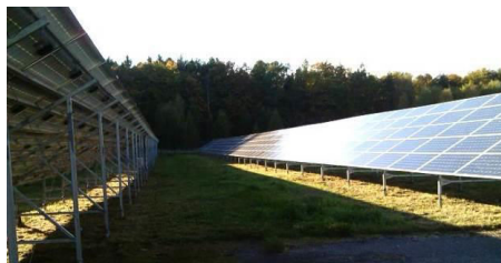
Obrázek 8 Zastínění části pole okolním porostem
