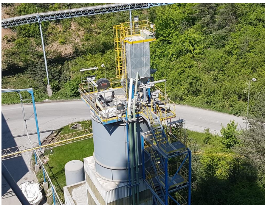
Obr. 4.5.1 – Zásobné silo práškového paliva
