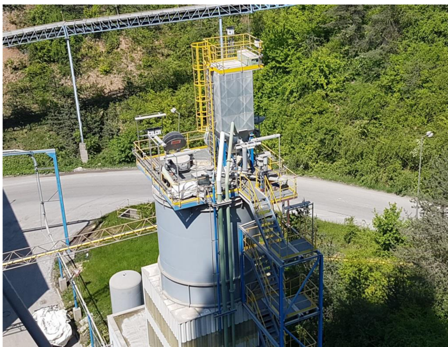
Obr. 4.5.1 – Zásobné silo práškového paliva
