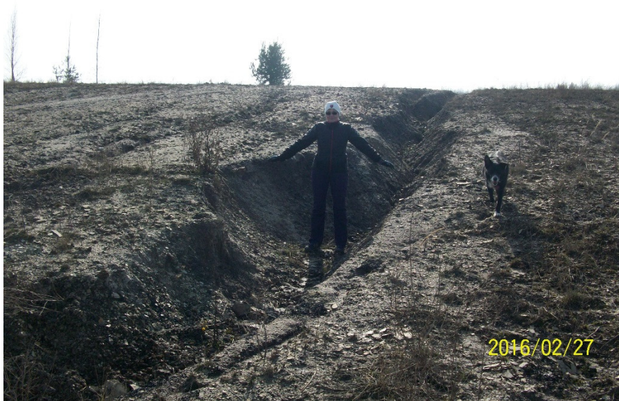
Obr. 5.3-5 Rozsah největší erozní rýhy na modelovém svahu v povodí jezera Medard.
