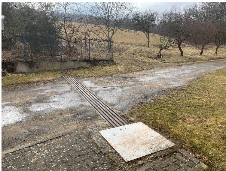
Obr. 43 Záchytný žlab svádějící srážky z KP3
