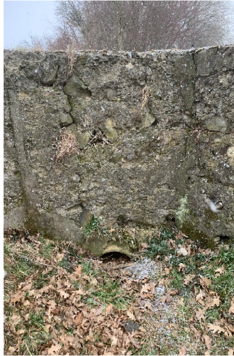
Obr. 34 Zahlcený propustek pod polní cestou v pravé části KP1
