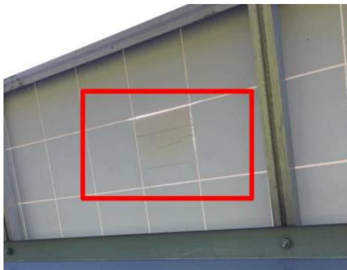
Obrázek 3: ukázka poškozených panelů [50]
