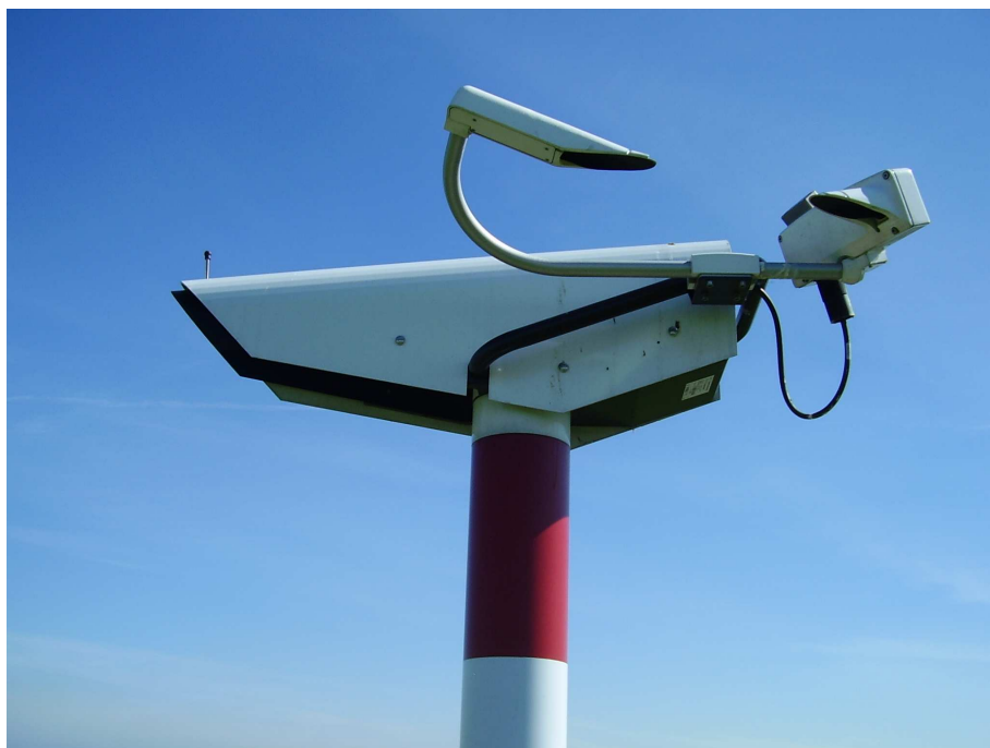
Obr. 10. PWD 22 instalovaný na vysílači LT 31
