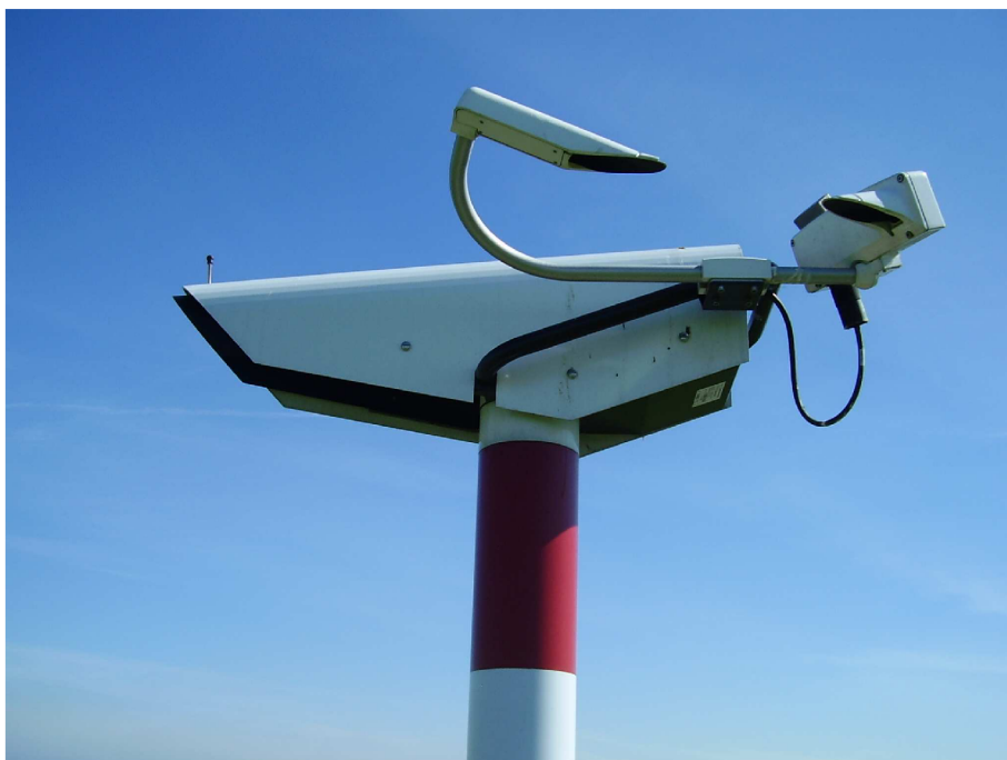
Obr. 10. PWD 22 instalovaný na vysílači LT 31
