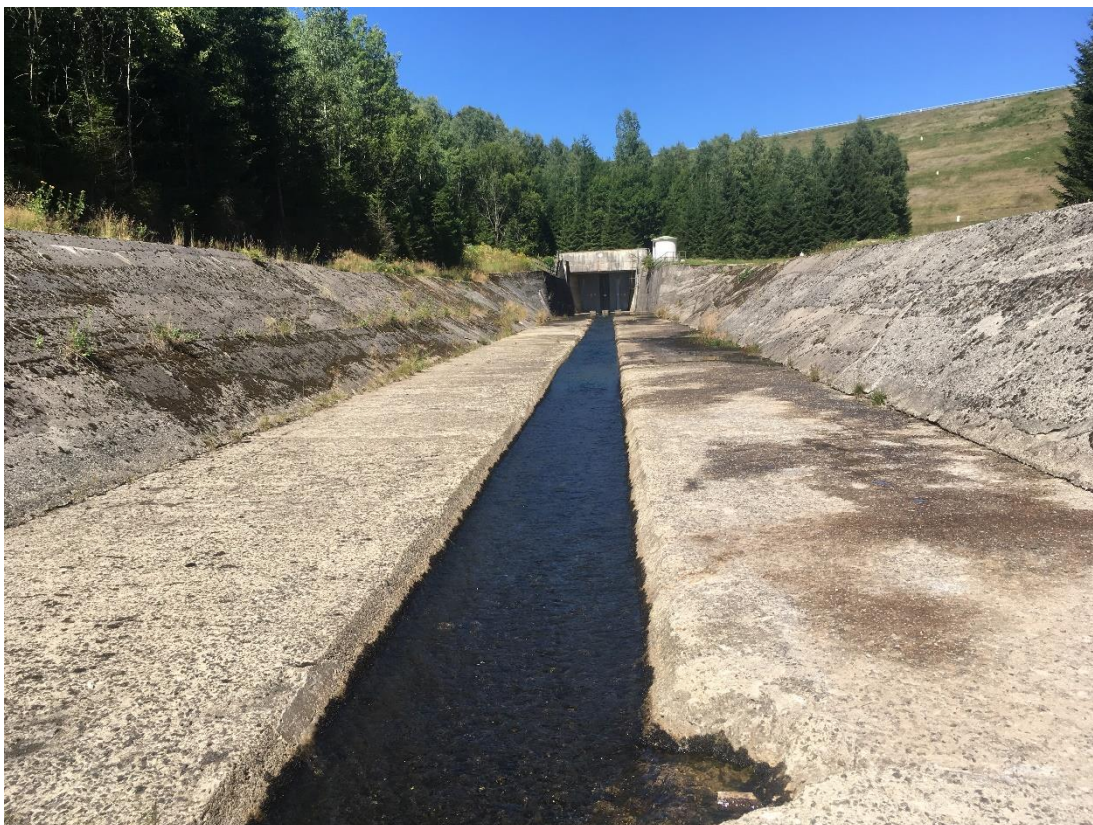
Příloha 10: Spodní výpust, vývar. (foto autor – 6. 8. 2018)
