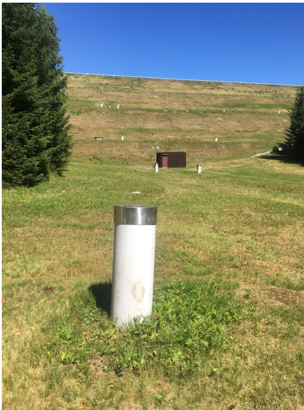
Příloha 12: Hlavní hráz VD Josefův Důl. V popředí jedna z 58 kusů tlakových sond pro měření údajů TBD. (foto autor – 6. 8. 2018)
