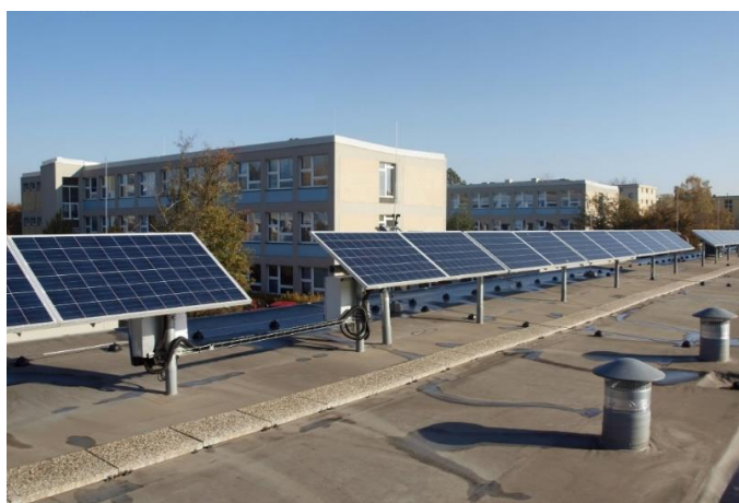
Obrázek 49 Síťový fotovoltaický systém instalovaný na střeše Technické fakulty České zemědělské univerzity v Praze
