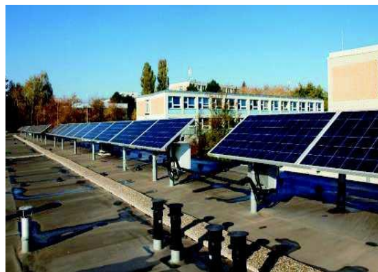
Obrázek 60 Fotovoltaický systém na střeše Technické fakulty
