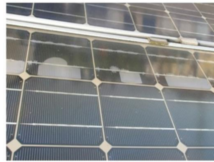
Obrázek 33 Delaminace mezi sklem předního krytu a zapouzdřením - a) Počáteční stav, b) Masivní delaminace
