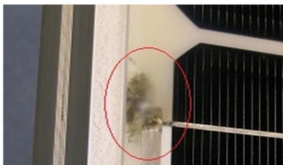
Obrázek 36 Delaminační vodivý kanál mezi sběrníci a rámem
