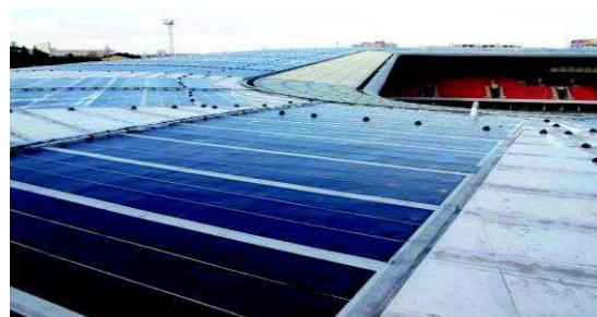
Obrázek 61 Fotovoltaický systém v Praze - Vršovicích
