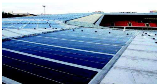
Obrázek 61 Fotovoltaický systém v Praze - Vršovicích
