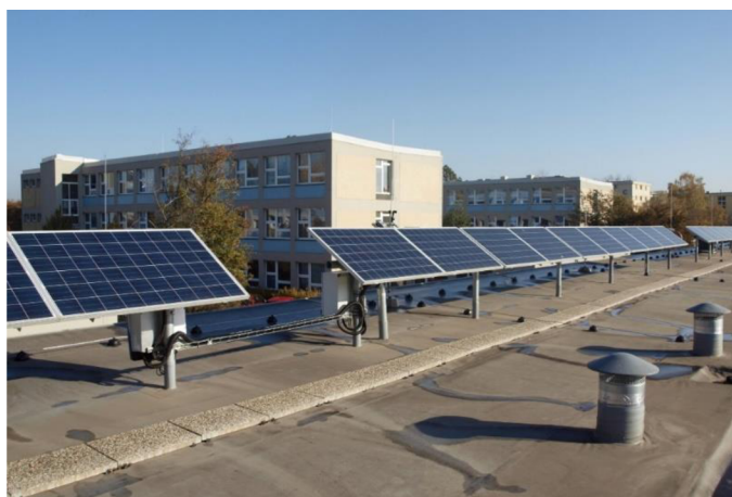
Obrázek 49 Síťový fotovoltaický systém instalovaný na střeše Technické fakulty České zemědělské univerzity v Praze
