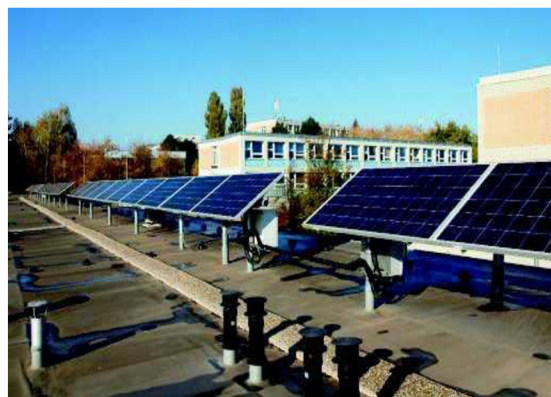
Obrázek 60 Fotovoltaický systém na střeše Technické fakulty
