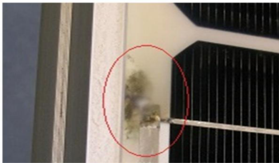
Obrázek 36 Delaminační vodivý kanál mezi sběrníci a rámem
