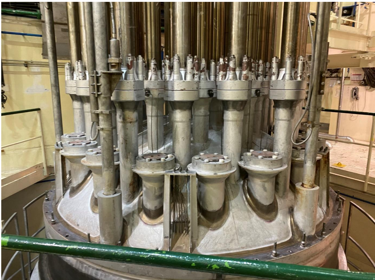
Obr. 8 Fotografie nátrubků HRK na víku reaktoru VVER 440.
